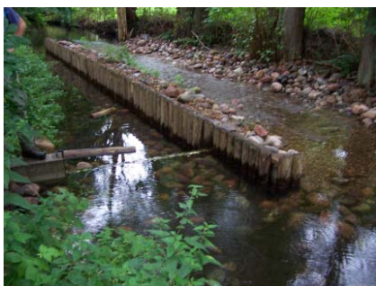
(3) Das Umgehungsgerinne am Staubauwerk Roofensee erhält die Durchgängigkeit für Wasserorganismen
