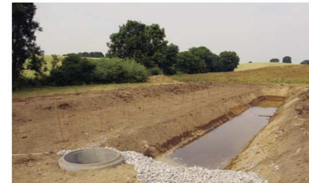
Beim Einrichten der Pufferzone wird ein parallel zum Bach verlaufender Graben angelegt.
