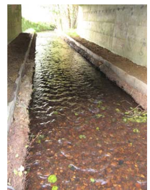
(2) Passierbarkeit für Wasser- und Landorganismen unter der Este-Brücke bei Welle an der B3.
